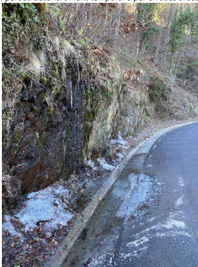
Imatge 3. Cuneta que no aconsegueix conduir l'escorrentia que baixa del talús i es diposita fora del canal en forma de gel.
