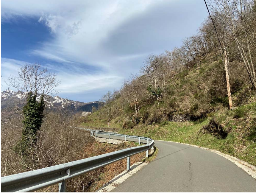
Imatge 02. Zona Mur d'escullera.(no es creuen dos vehicles i primers símptomes de fallida estructural)
